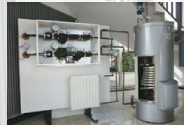
Fernwärmeübergabestation mit Warmwasserbereitung
